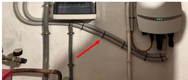
Figura 7: detalle de canalización eléctrica interior con trazado inclinado.
