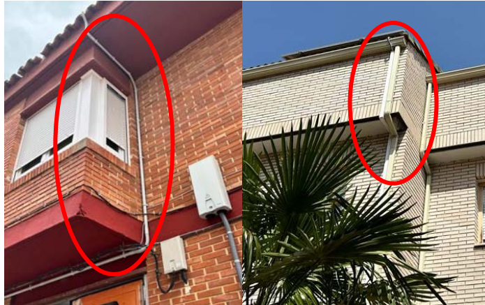
Figura 3: canalizaciones eléctricas exteriores de material plástico.
