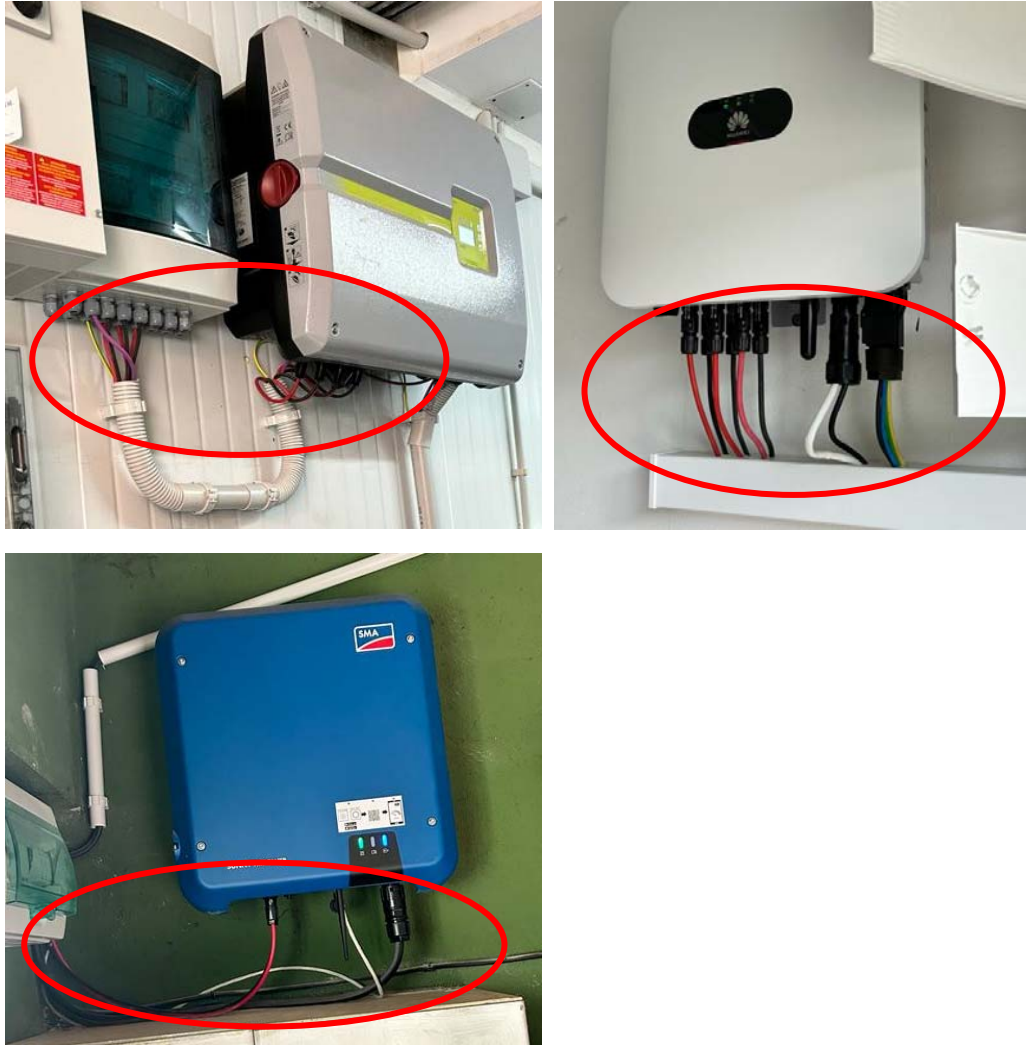
Figura 8: conexiones eléctricas a los inversores.
