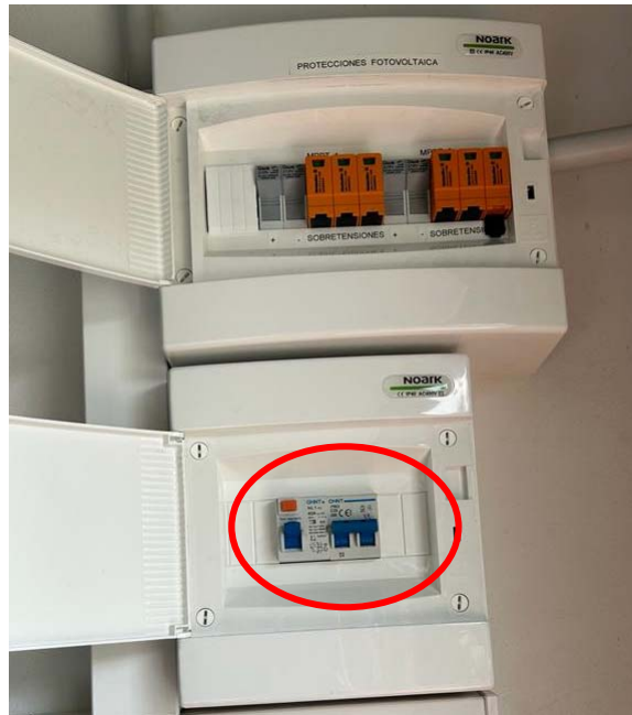
Figura 9: caja de protecciones CA a la salida del inversor con diferencial y magnetotérmico pero sin protección contra sobretensiones. El cuadro superior corresponde a la caja de CC, que contiene seccionadores portafusibles y protecciones contra sobretensiones.
