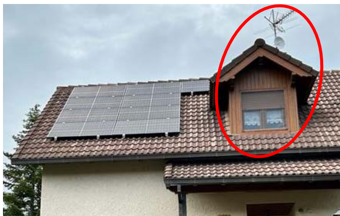
Figura 2: Elemento arquitectónico en tejado que puede proyectar sombras sobre los módulos FV.
