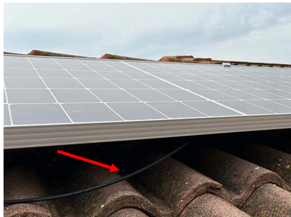
Figura 4: cable de conexión de los módulos no fijado al marco.
